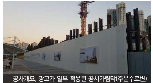
| 디자인 적용 없이 설치된 공사가림막(인천타워대로)
