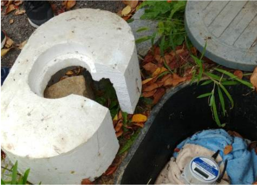
[ 그림 2 - 61 ] 동파방지 스티로폼 파손의 경우
