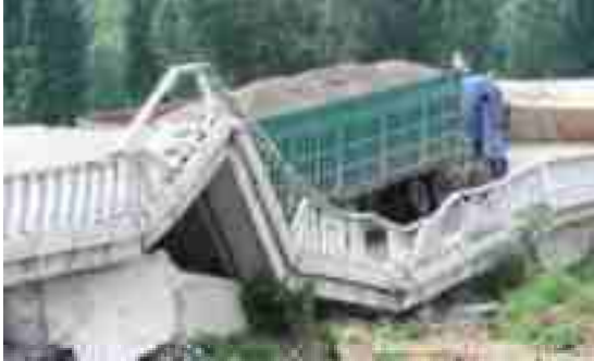
〈그림 2.2-2〉 중차량에 의한 교량 붕괴
