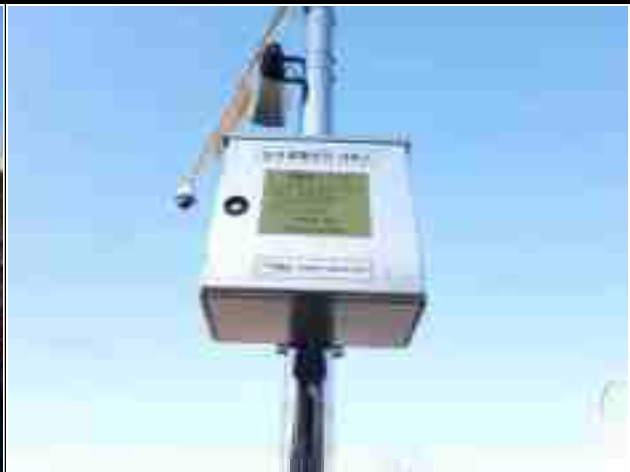
교량 주변 다목적 CCTV(U-City)
