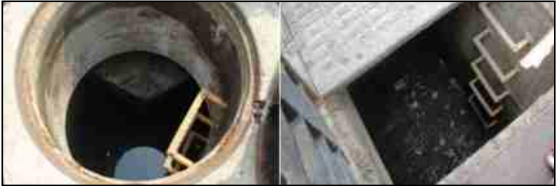
[그림 3.3-17] 용인시 여과형시설 예시
