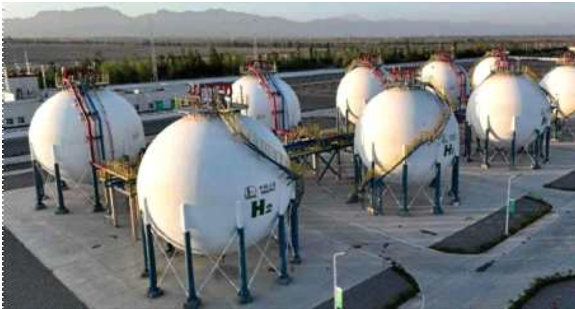
<그림 2-8> 중국 260MW 그린수소 프로젝트(수소 저장탱크)
