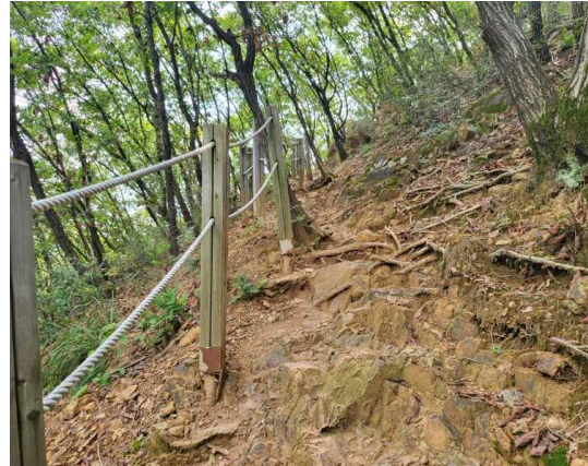
안전시설 관리 부실로 인한 유실 위험
