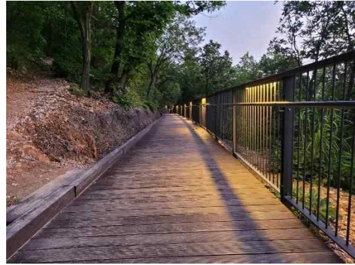
야간 조명 설치 현황
