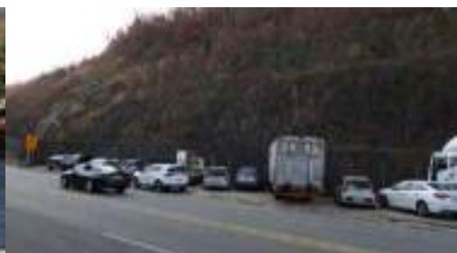
도로변 법면 및 주차장 입지 훼손지
