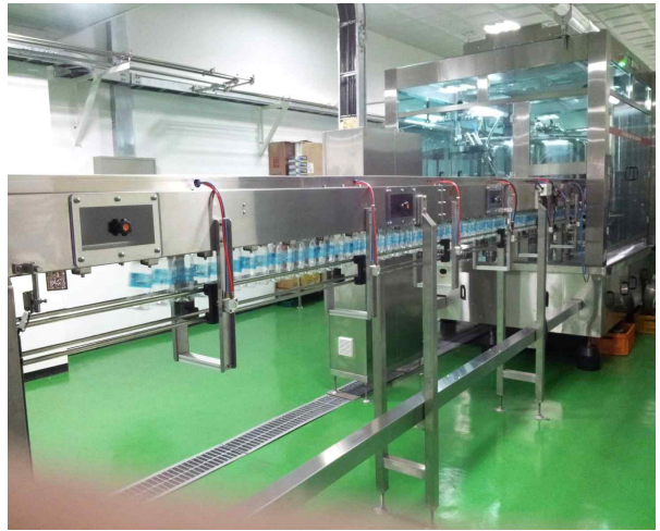
병입 미추홀참물 공장 내부
