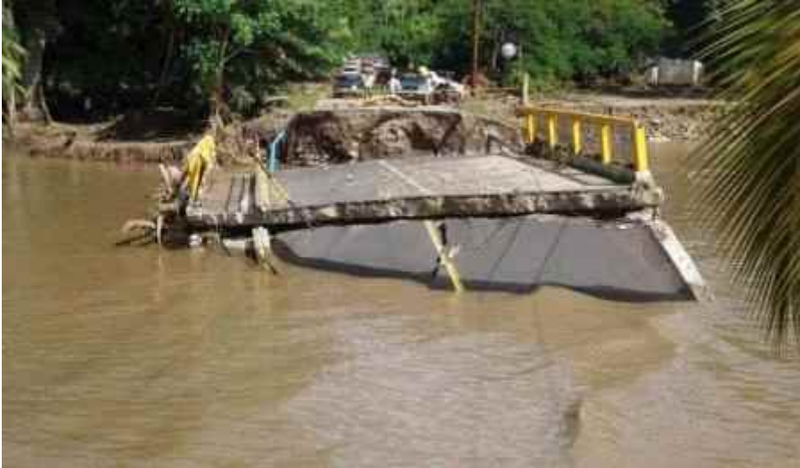
Batalie bridge – one of the several bridges damaged or destroyed by Tropical Storm Erika 바타리 교량 - 열대폭풍 에리카로 손상되거나 파괴된 교량 중의 하나
