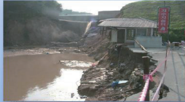
(2002년 태풍 루사 - 강원도 강릉시 지변저수지 붕괴)
